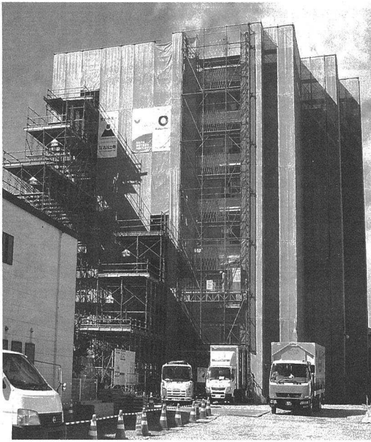
旧ホテル古川ゴルフデンパレス跡地で工事が進む古川十日町住宅
